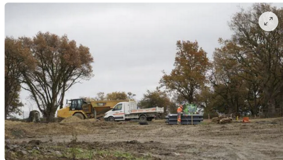
Les travaux en cours, près de Bouchemaine, là où 71 habitations vont être construites. | OUEST-FRANCE
